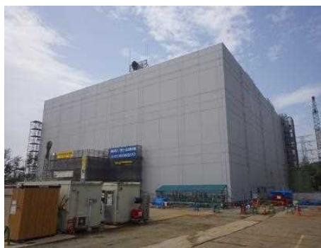
雑固体廃棄物焼却設備
