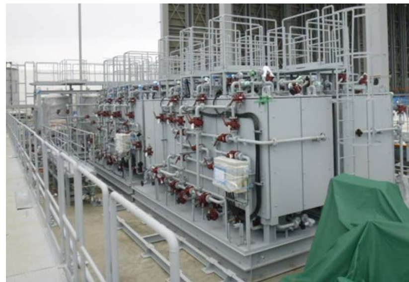
吸着塔の外観
