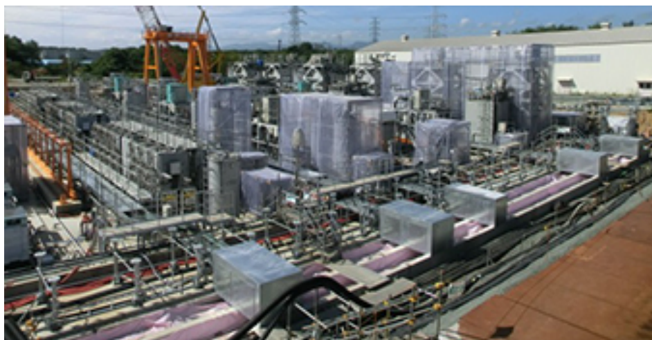
機器の設置状況
