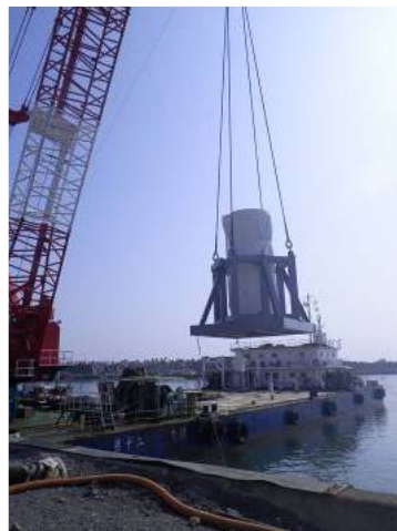
吸着塔水切り(サイト)
